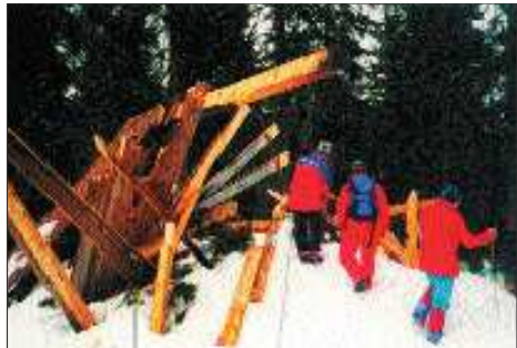
Die Bergwacht Krün besichtigt die zerstörte Talstation
